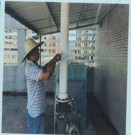
废气排放口 FQ-0001
